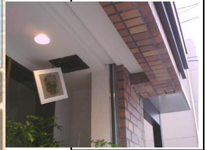
2019/6/21 漏水被害箇所 赤外線撮影 散水試験前
